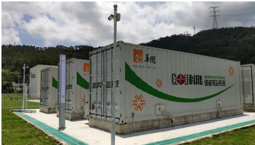
△ 华润海丰 30MW/14.93MWh 储能辅助调频项目（来源：高工锂电）
